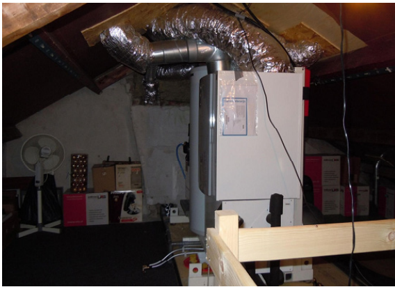
Voorbeeld Stadskanaal: voorgevel vóór en na de renovatie en een zolder vrijwel vol met installaties.
